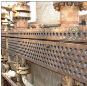
Fin Fan cooler before maintenance
